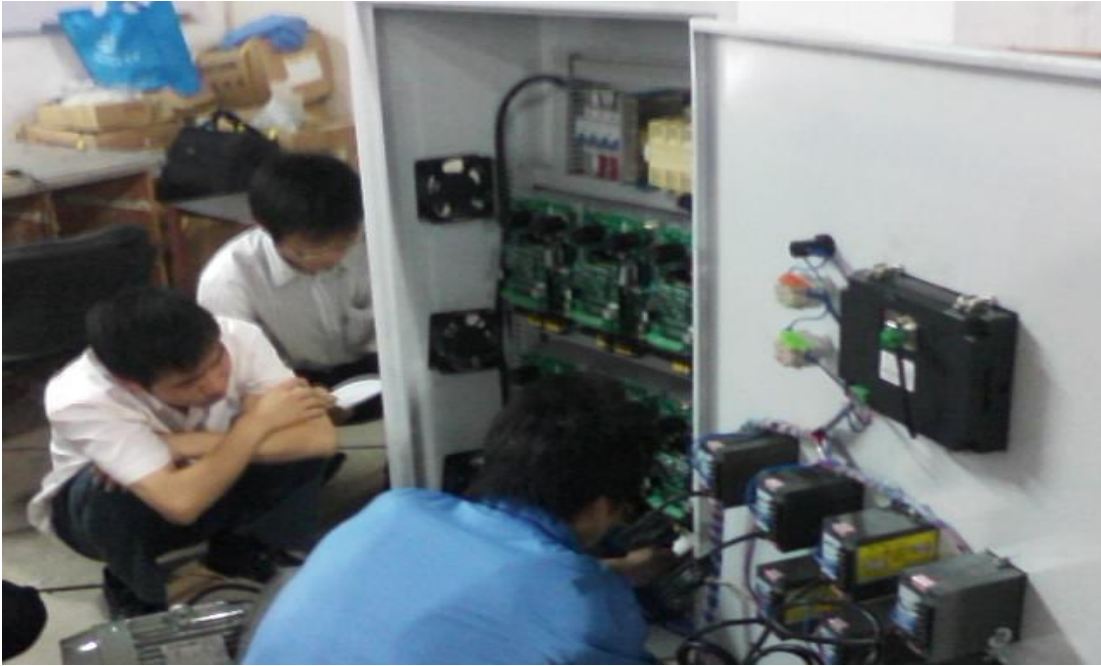
稳定运行的电控系统
